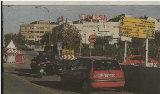
En los tramos en obras se suele descuidar la señalización: no existe, está mal colocada o se abandona al acabar (zona Fuencarral, Madrid). / M. ESCALERA
